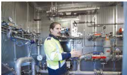
RNG-Projektverantwortlicher Felix Schönwald erklärt das „Innere“ der Wasserstoff-Einspeiseanlage.
